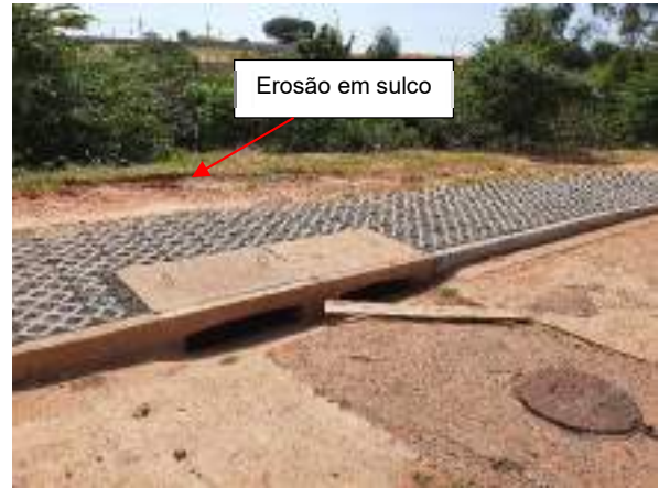
Foto 2. Erosão a jusante de boca-de-lobo.
