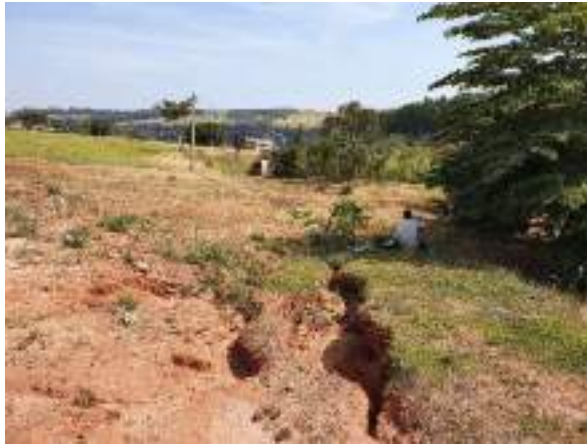
Foto 3. Detalhe de erosão em sulco a jusante de boca-de-lobo.
