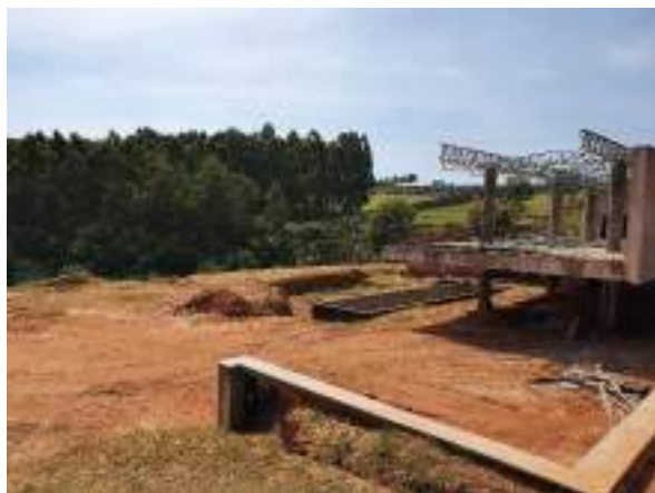
Foto 9. Vista do salão de festas do empreendimento, com obras paralisada.
