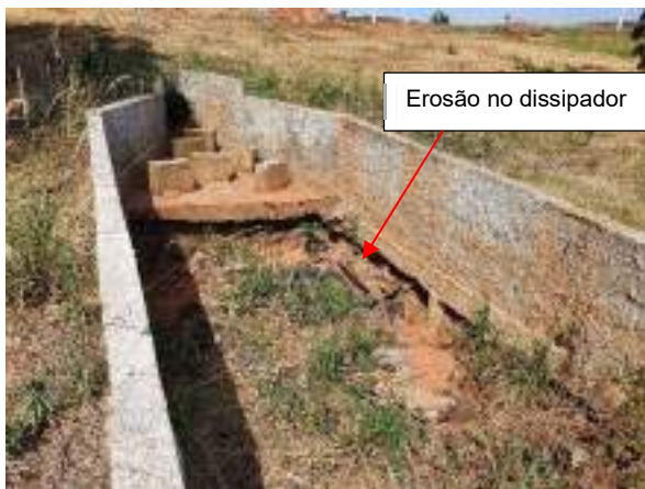
Foto 5. Detalhe de erosão do solo e dos blocos do tapete de enrocamento do dissipador.
